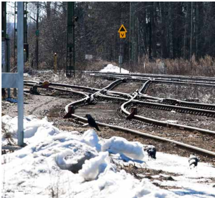
Snö och is under vintern ställer krav på uppvärmning av växlar.
