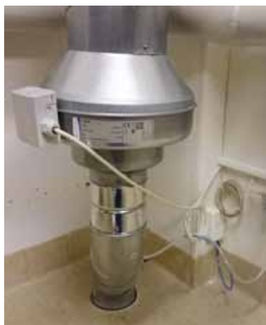
Monterad fläkt inomhus
