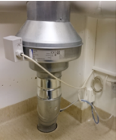
Monterad fläkt inomhus
