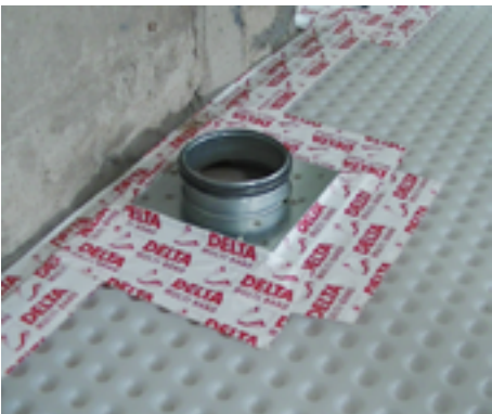
34. Färdig monterad sugpunkt.
