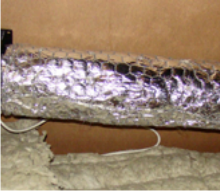
37. Vid kanaldragning i kalla utrymmen, till exempel på vind, kondensisoleras kanalen men inte fläktmotorn.
