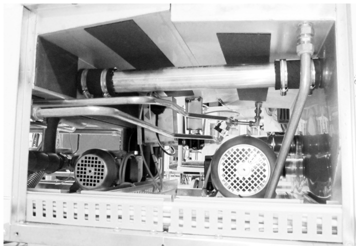
Överrinningsrör mellan slutsköljningstank (till vänster) och kemdisktank
