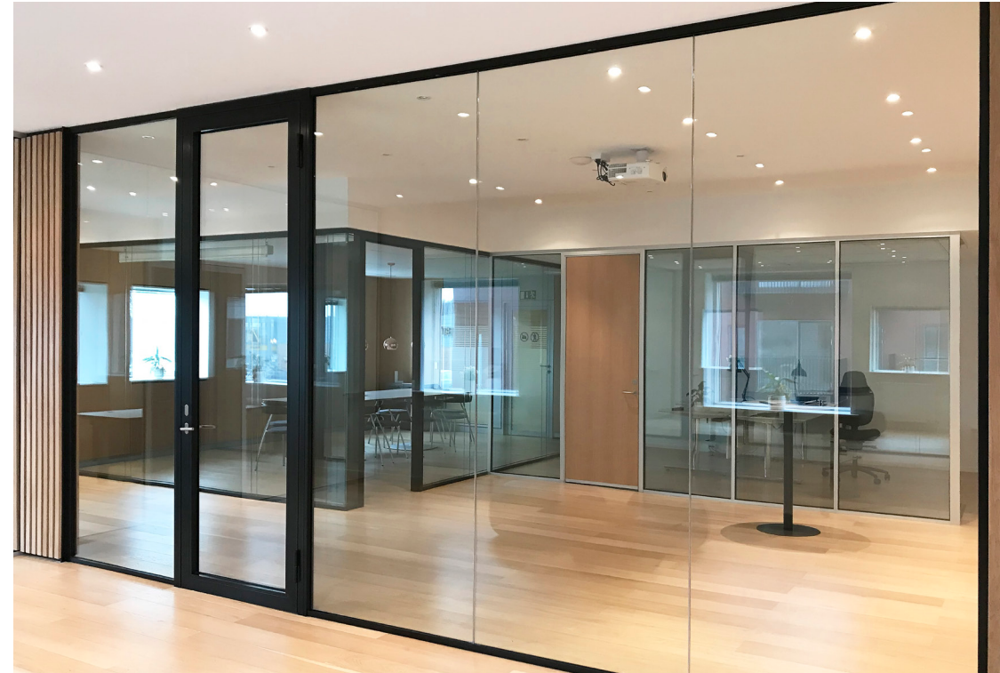
Glass Front | Fire EI 30. Fogade skarvar och stålramsglasdörr i fullhöjd
