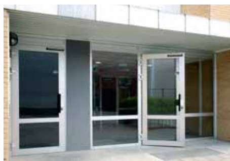
Aluminiumdörrar och fasadpartier
