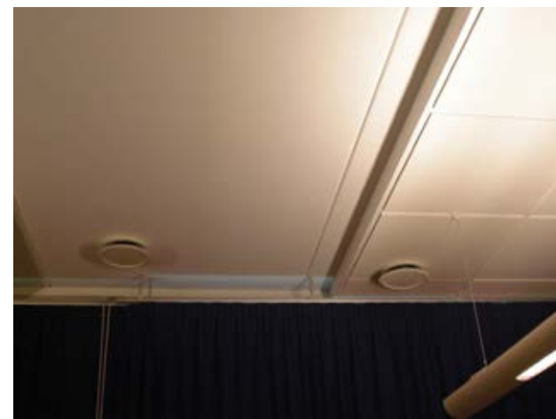
Akustiken i klassrummen löstes i form av ljudabsorbenter i stråk, närmast takvinkeln och på väggarna. Tilluftsdonen sitter vid ytterväggen.
