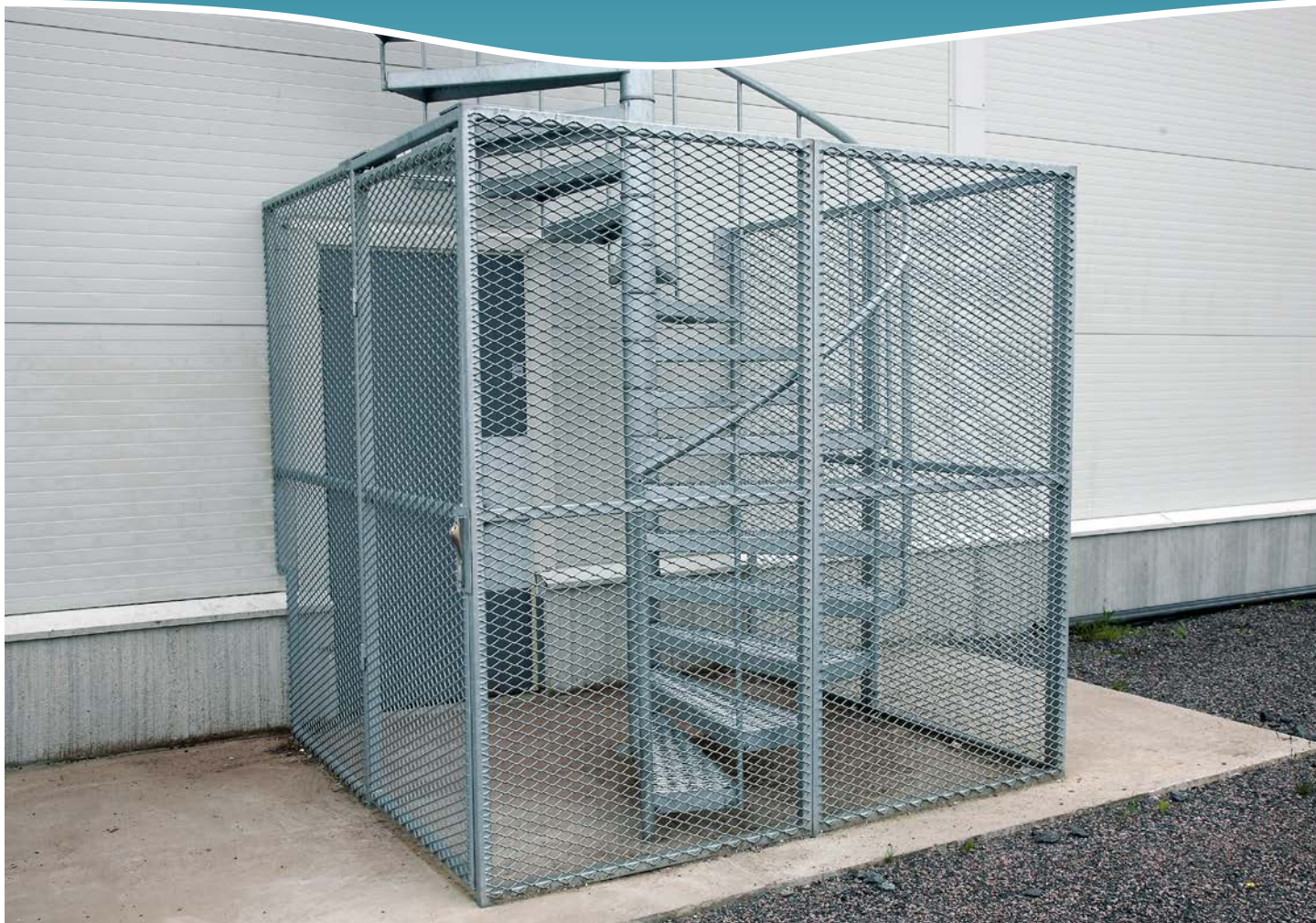
Spiraltrappa med skyddsbur av sträckmetall.
