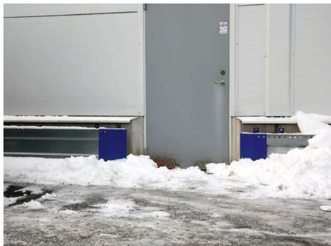
Påkörningsskydd vid vägg utomhus.
