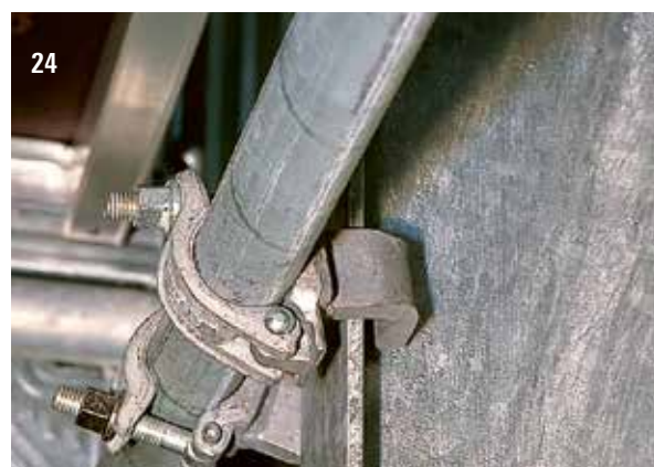
24 Balkkopplingar monterade mot stål balk.
