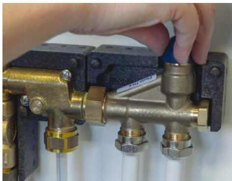
12. Öppna ventilen på radiatorkopplet.
