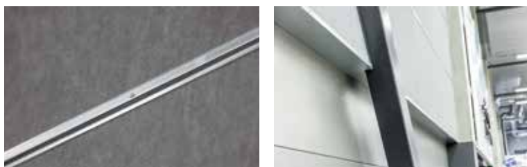
Absorbenterna på arenans kortsidor är monterade med MT profiler i en lösning som lämnar en luftspalt bakom skivorna.
