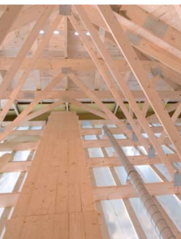
2.9 Ventilationskanaler, vattenrör och andra installationer.
