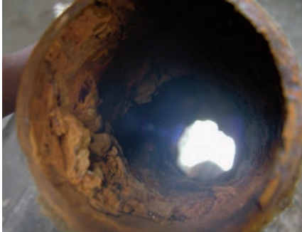
Galvaniserade kallvattenrör innan Bauer vattenbehandling har installerats
