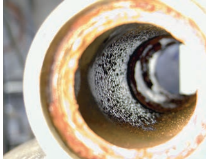
Samma galvaniserade kallvattenrör ca 16 månader efter installationen av Bauer
